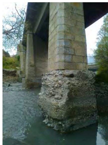
Pilastri di ponte scalzati lungo la Dora Riparia
