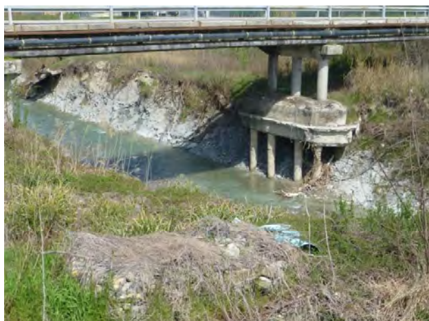
Fig.24. 27.3.2016, ponte di V. Serrabella; il pericolo per la stabilità del ponte risulta evidente: si noti l'erosione e incisione dell'alveo
